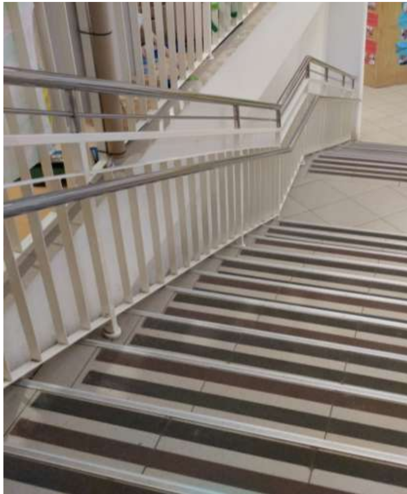
Слика бр. 15: Противклизна трака на степеништу
